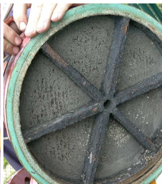
Barrera apagallamas obstruida
